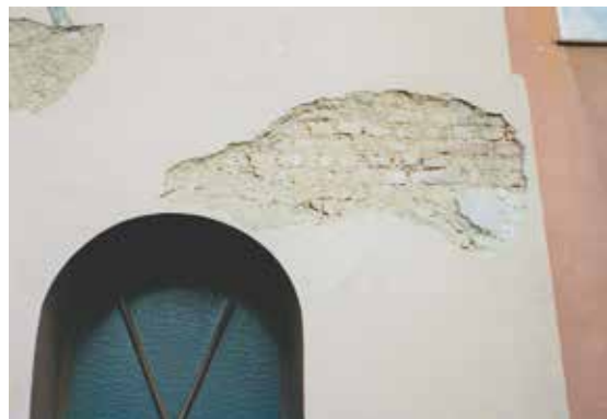
Putz blättert von der Fassade
