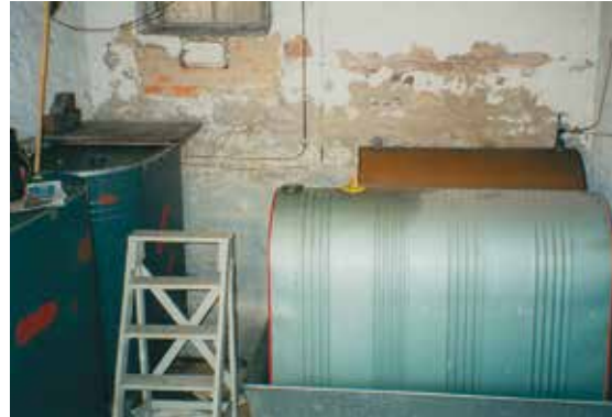
Alter Öltank in feuchtem Keller
