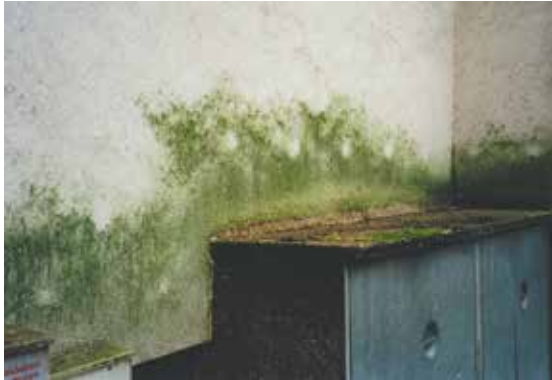
Algenbefall auf der nachträglich angebrachten Wärmedämmung an der Nordseite
